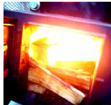
写真3 薪ボイラーの点火、燃焼状況
