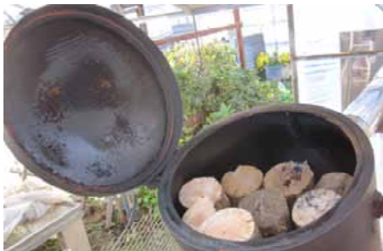
写真2 薪ボイラーに燃料用間伐材を入れたところ。
