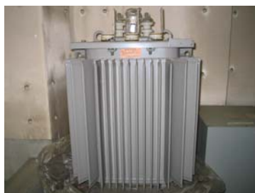
高圧トランス
