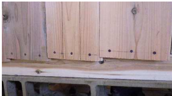
図-13 試験体 1 の板間の滑り
