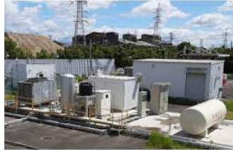
水素供給設備例
