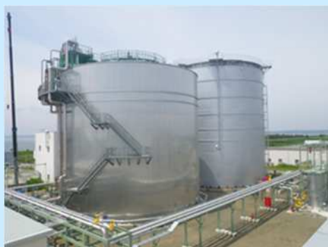
矢作川浄化センターの 下水汚泥メタン発酵施設
