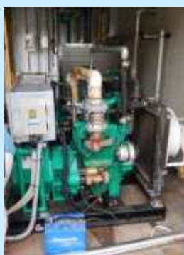
メタンガス発電機
