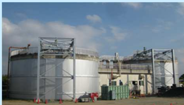
豊川浄化センターの下水汚泥メタン発酵施設
