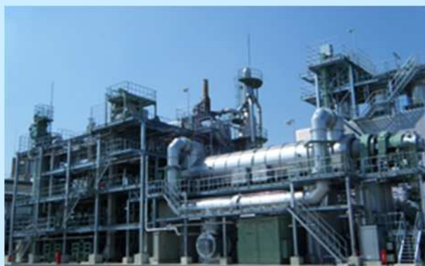
衣浦東部浄化センターの下水汚泥燃料化施設
