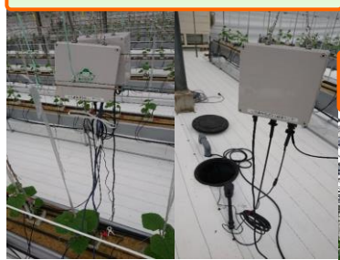
環境測定機「あぐりログ」による環境データ・給排水データの収集
