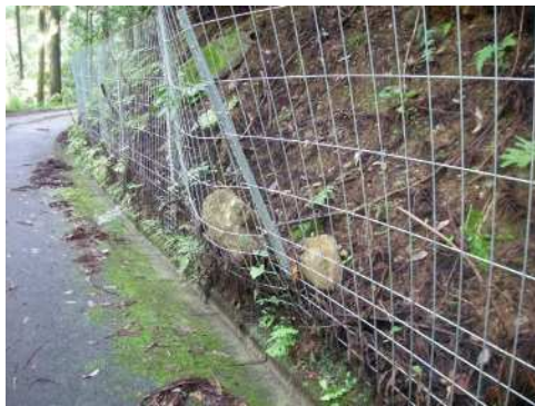
ワイヤーマッシュ柵は破損すること多い
