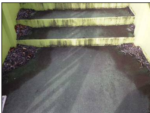
写真 3.5.9-3 踊り場部の土砂堆積事例
