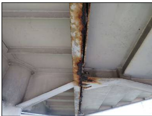
写真 3.5.9-10 接合部の腐食事例
