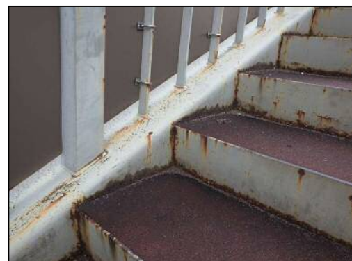
写真 3.5.9-4 階段部の腐食事例
