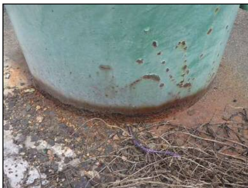
写真 3.5.9-6 橋脚基部の腐食事例
