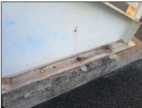
写真 3.5.9-8 アンカーボルトの腐食事例
