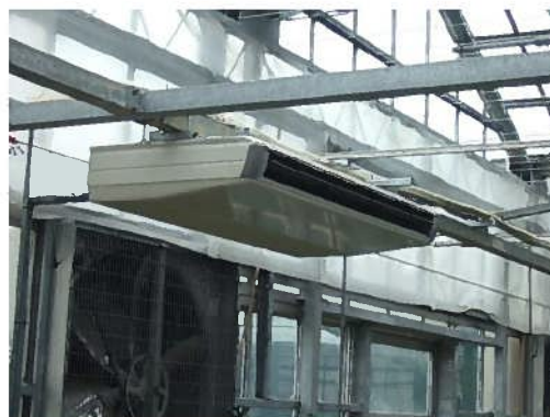
ヒートポンプエアコン本体（西尾市）
