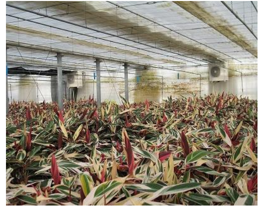
ヒートポンプの利用状況
