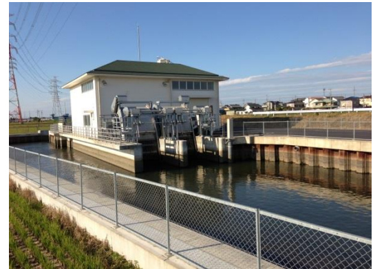
(西尾市 行用排水機場)
