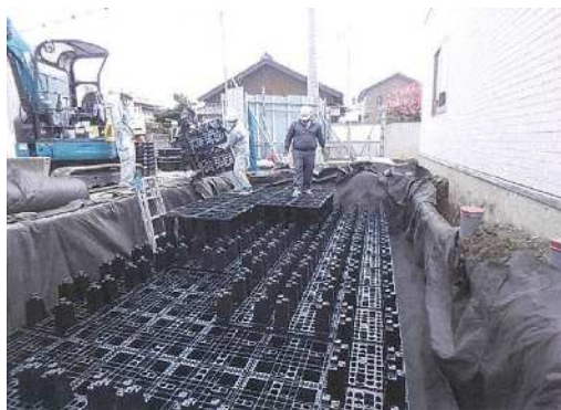
布袋北小学校学童室貯留槽 (江南市)
