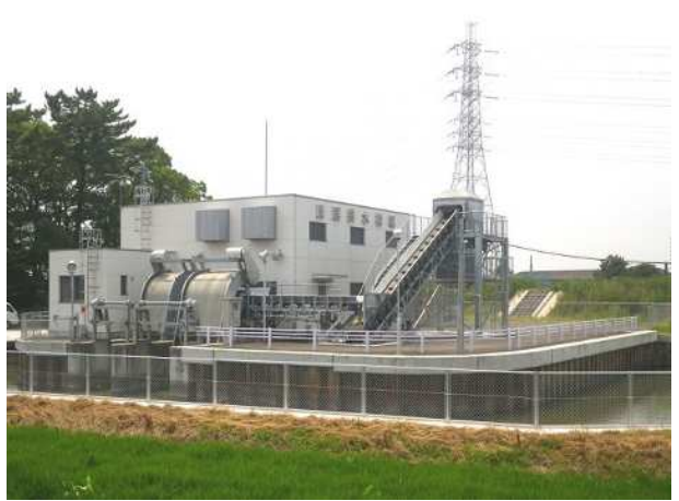
整備された排水機場
