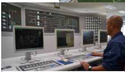
取水量を変更している作業状況
