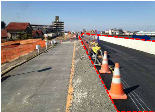
①新川：堤防嵩上げ状況
