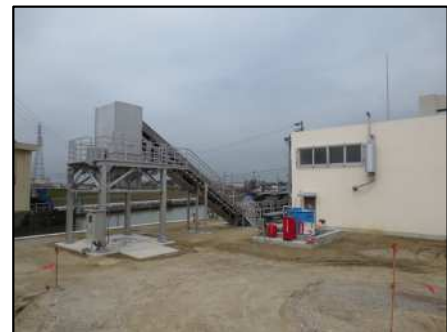
除塵機設備（前新田排水機場：刈谷市）
