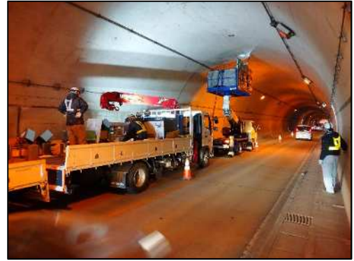
経営体育成基盤整備事業 西幡地区 農道トンネル補修工事(西尾市)
