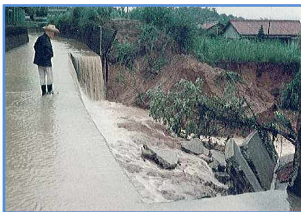
昭和47年の豪雨で被災した枝下用水幹線水路
