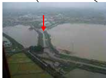
広田川の破堤状況(額田郡幸田町) 【平成20年8月末豪雨時】
