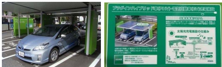
豊田市役所西庁舎駐車場の EV・PHV 充電施設
