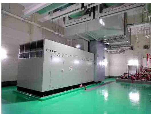
【非常用自家発電設備の整備】
