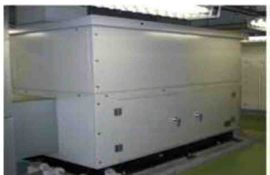
【非常用発電機（東三河総合庁舎）】
