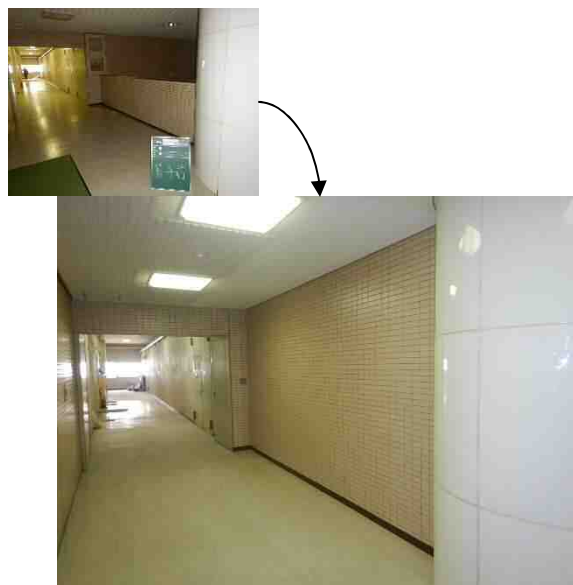
【処理場施設の耐震化】
