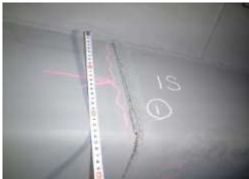
写真 10.1.1 鋼床版Uリブ現場溶接部の疲労亀裂
