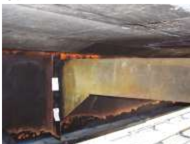
（塗膜が完全に消失している：横桁）
