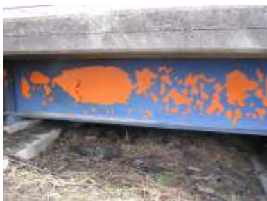
（上塗りの塗膜がはがれている）
