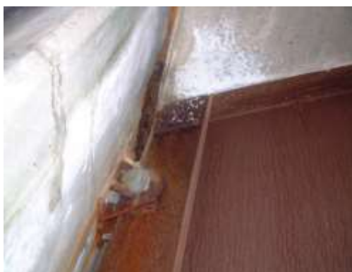
写真 10.1.2 伸縮継手部からの漏水
