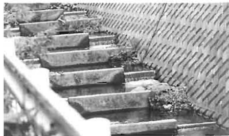
写真-6 魚類対策を施した落差工（秋田自動車道）
