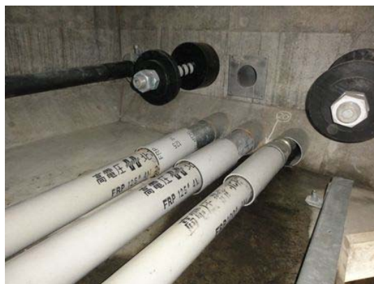
写真 2.7.1 PC 箱桁の桁端添架物開口からの漏水の事例
