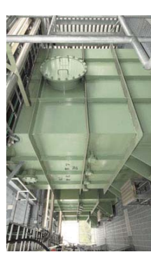
⑦炭化物ホッパー (20m 3 ×3基) 下水汚泥炭化燃料(炭化物)を一時貯留します。
