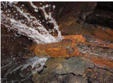
継手部の漏水状況
