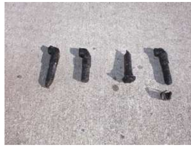
継手ボルトの腐食状況
