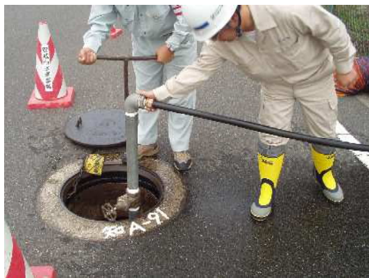
写真1 応急給水支援設備操作状況
