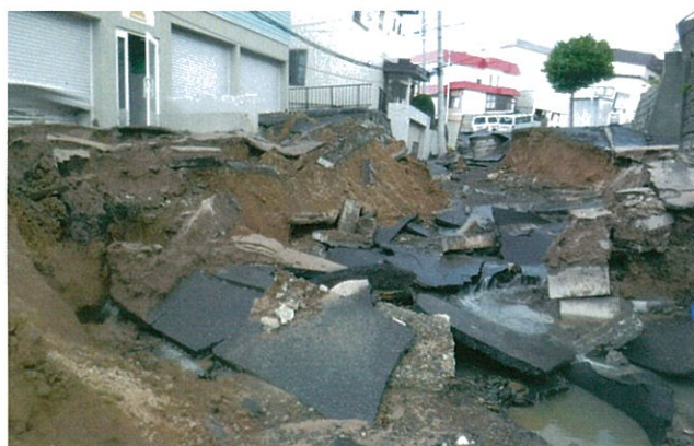
札幌市内の液状化の様子(提供:札幌市役所)
