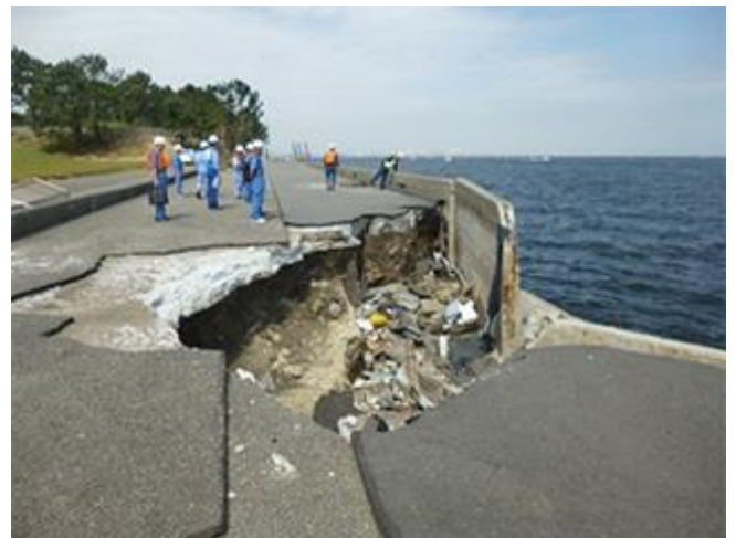
被災した護岸の状況(横浜市金沢区)
