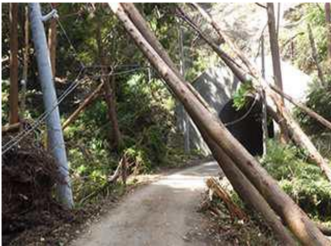
電柱・倒木倒壊の状況(鴨川市内)
