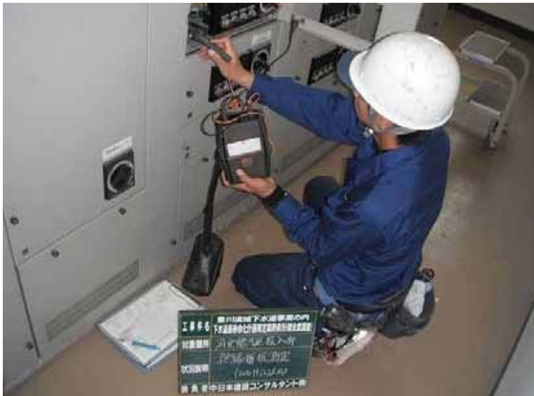
機器名:消化槽汚泥投入弁
