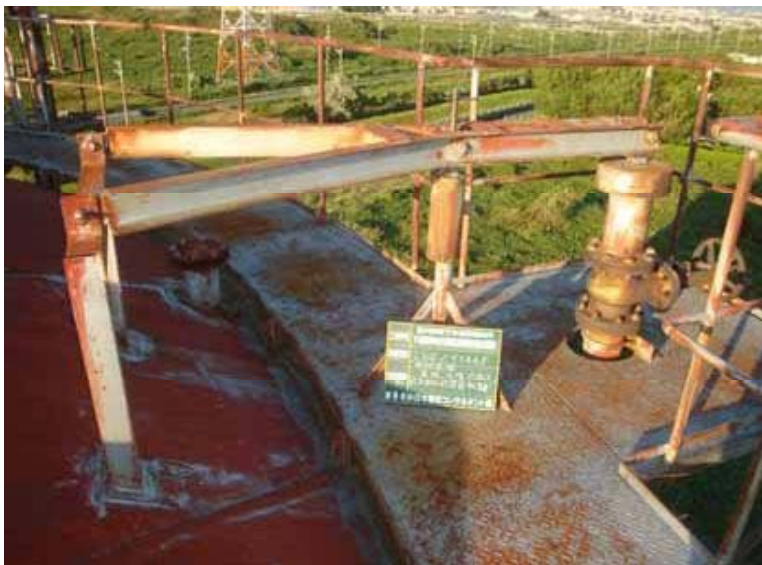
機器名:ガス貯留タンク
