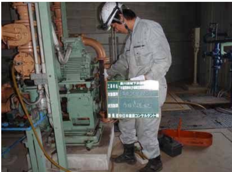
機器名:消化汚泥ポンプ
