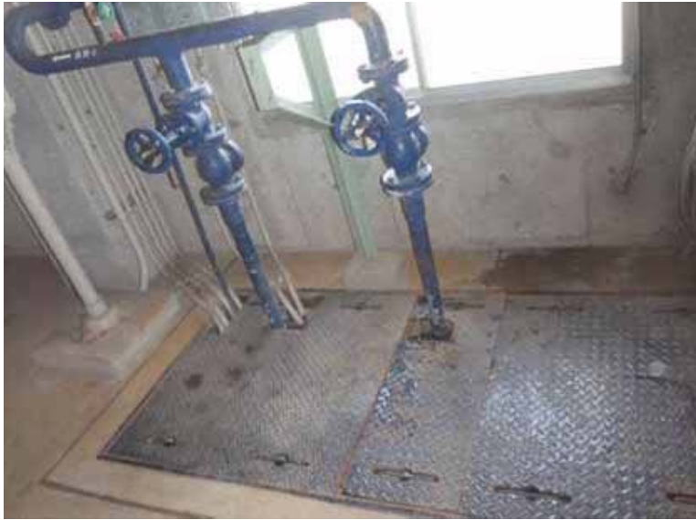
機器名:消化槽弁操作室用床排水ポンプ
