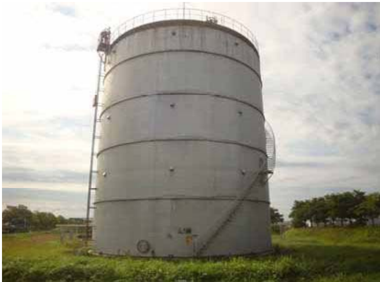
機器名:ガス貯留タンク
