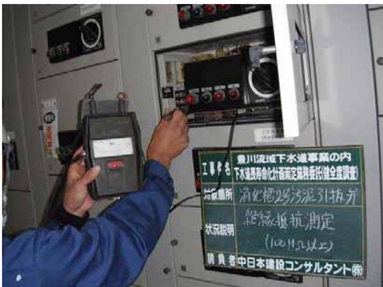
機器名:消化槽 2号汚泥引抜き機
