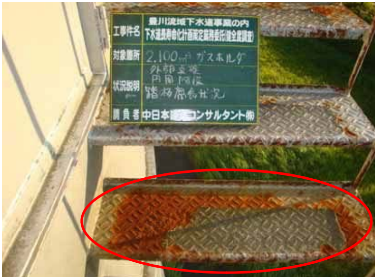
機器名:ガス貯留タンク
