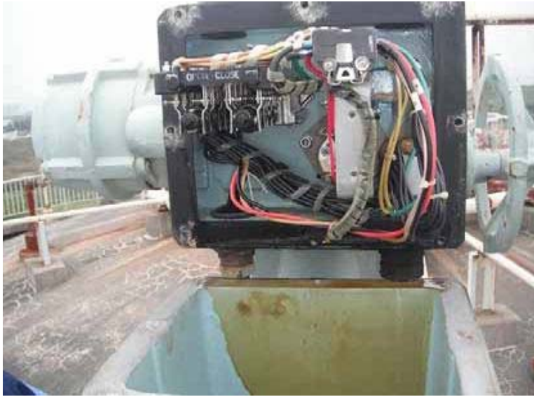
機器名:消化槽汚泥投入弁
