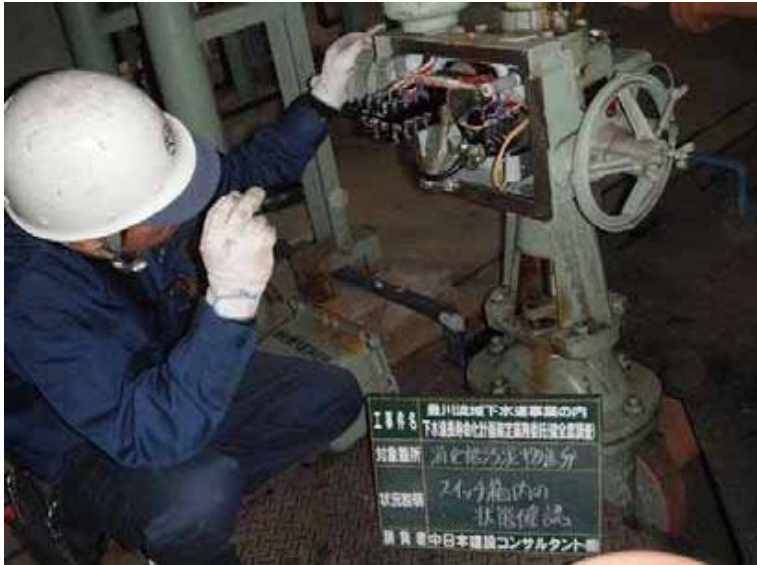
機器名:消化槽汚泥移送弁
