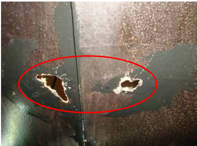
機器名:ガス貯留タンク
