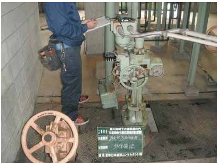
機器名:消化槽汚泥移送弁
