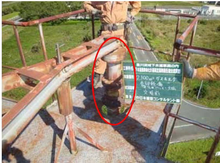
機器名:ガス貯留タンク
