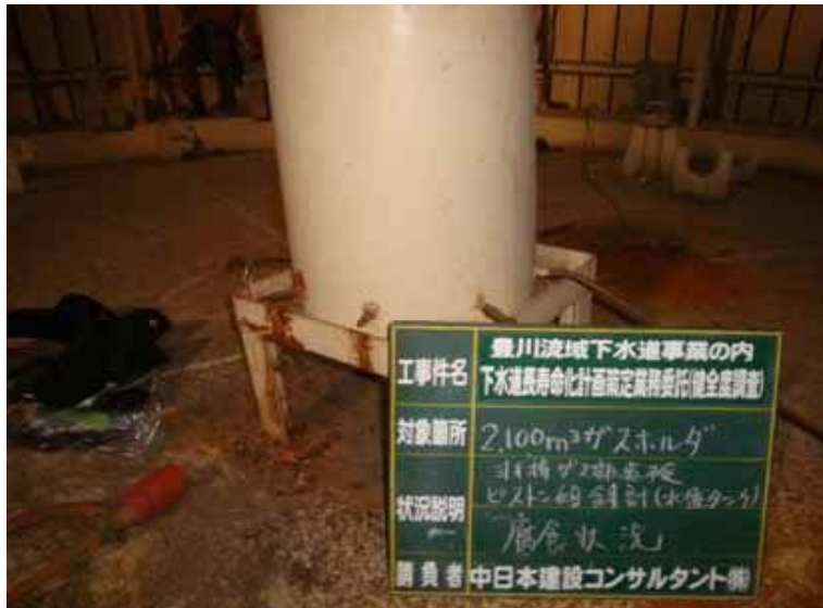
機器名:ガス貯留タンク
