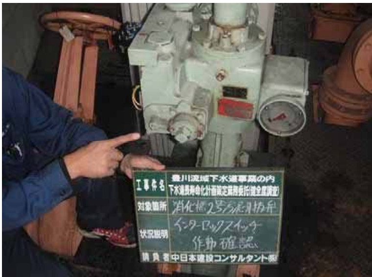
機器名:消化槽 2号汚泥引抜き機
