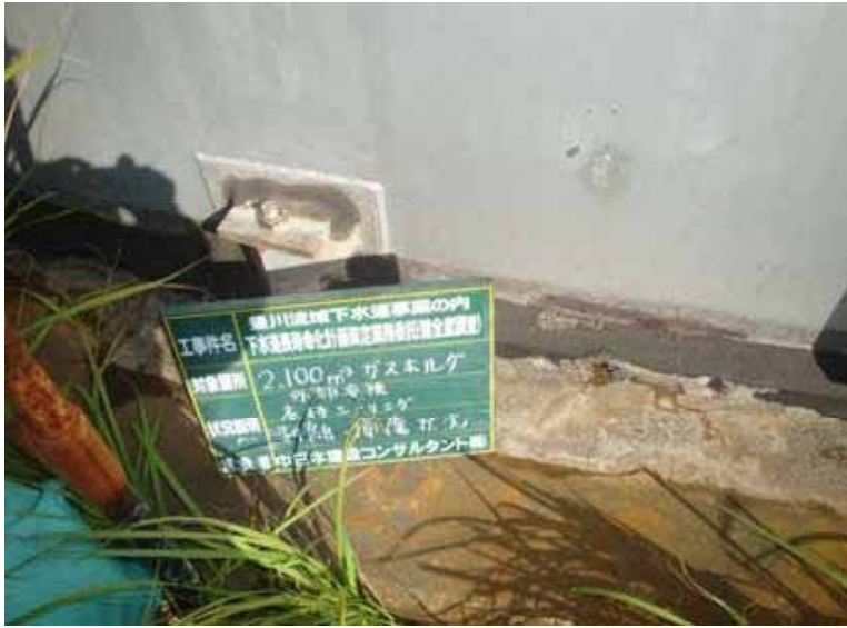
機器名:ガス貯留タンク
