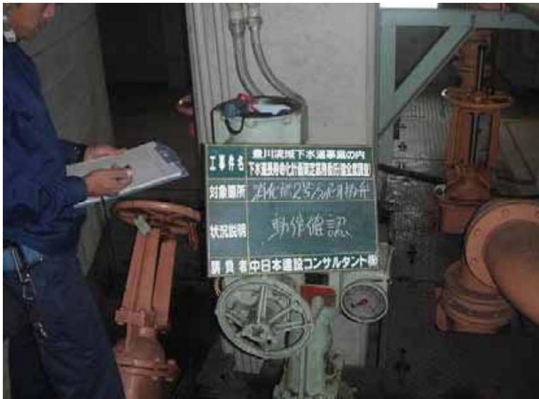
機器名:消化槽 2号污泥引抜弁
