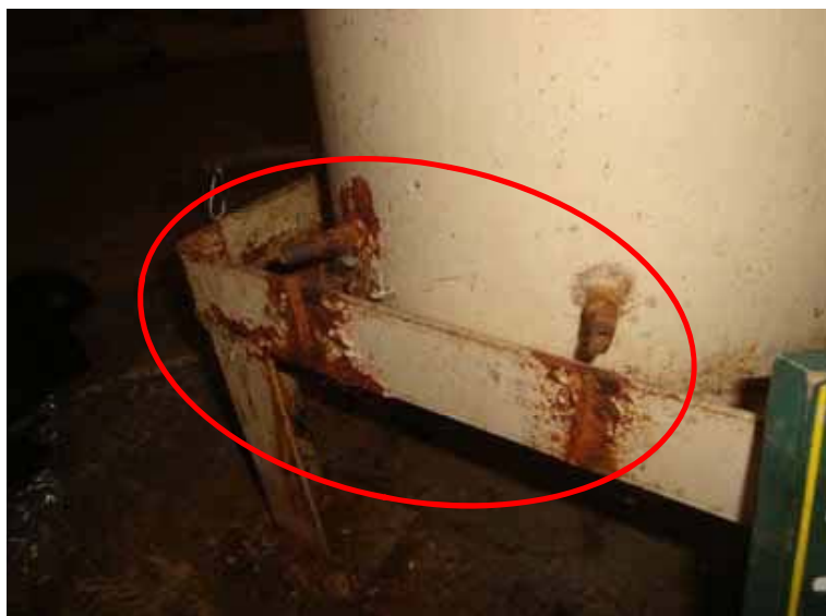
機器名:ガス貯留タンク
