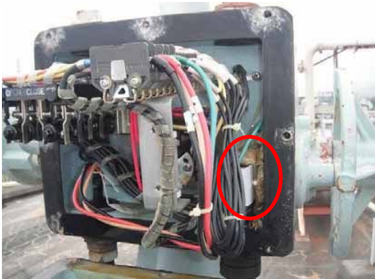
機器名:消化槽汚泥投入弁
