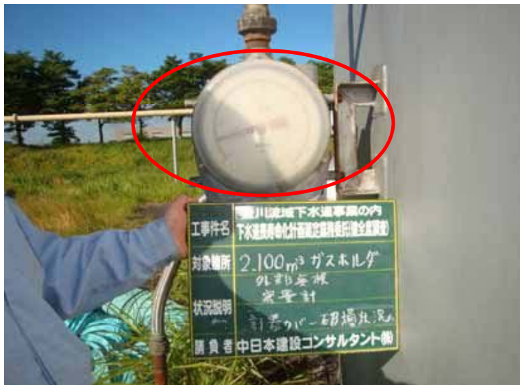
機器名:ガス貯留タンク
