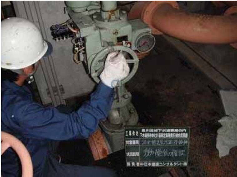
機器名:消化槽 2号汚泥引抜き機
