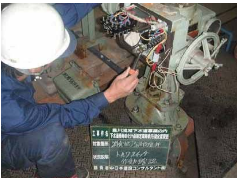
機器名:消化槽汚泥移送弁
