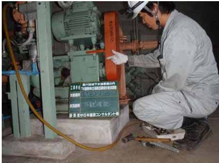
機器名:消化汚泥ポンプ
