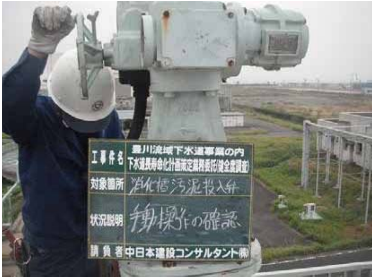
機器名:消化槽汚泥投入弁
