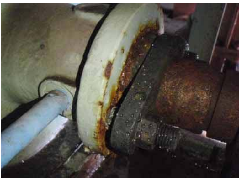
機器名:消化汚泥ポンプ
