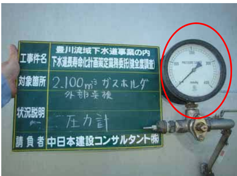
機器名:ガス貯留タンク
