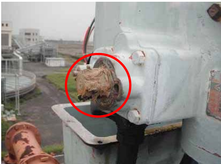
機器名:消化槽汚泥投入弁
