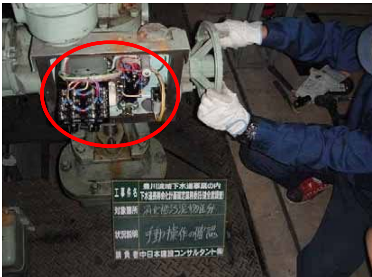
機器名:消化槽汚泥移送弁
