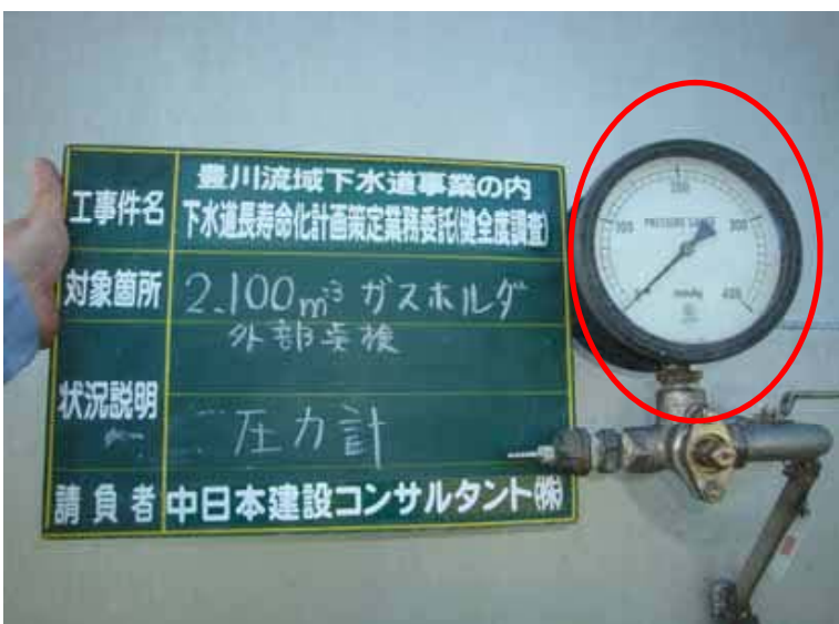
機器名:ガス貯留タンク
