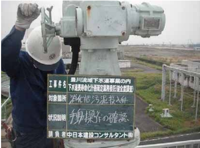
機器名:消化槽汚泥投入弁
