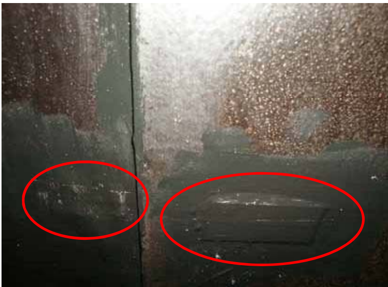
機器名:ガス貯留タンク
