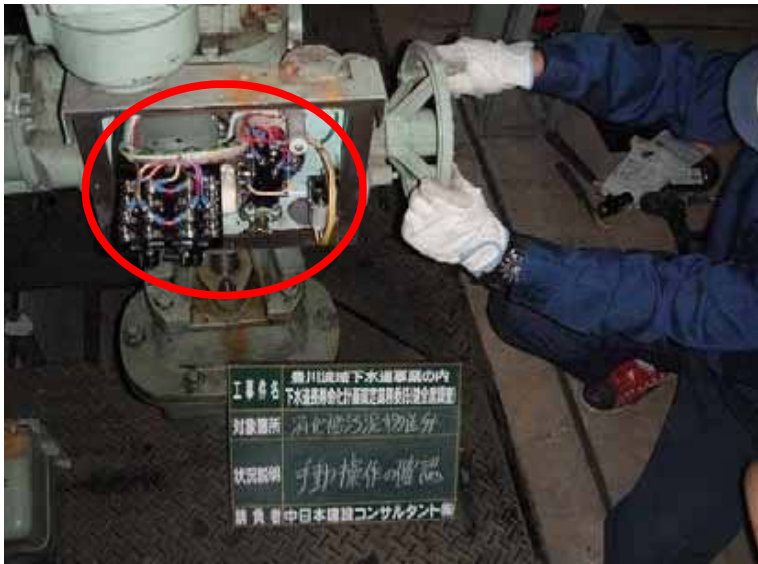
機器名:消化槽汚泥移送弁
