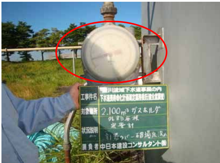
機器名:ガス貯留タンク
