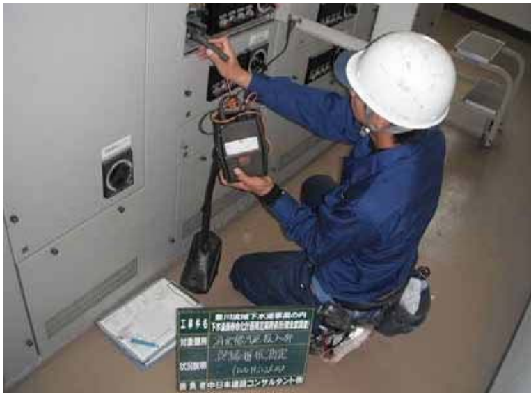
機器名:消化槽汚泥投入弁
