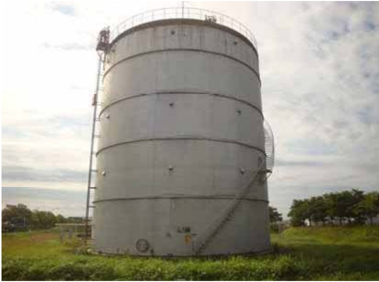
機器名:ガス貯留タンク
