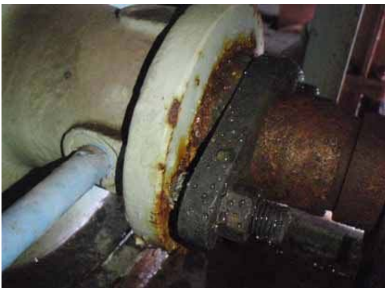
機器名:消化汚泥ポンプ
