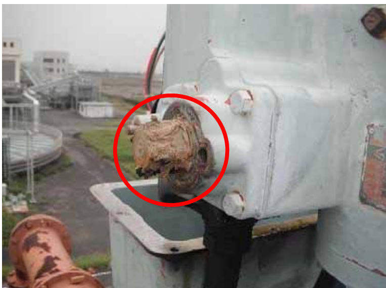
機器名:消化槽汚泥投入弁
