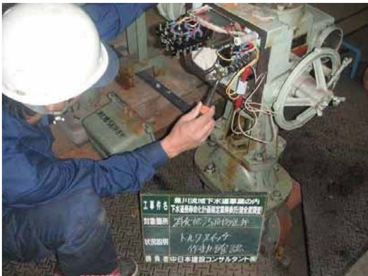
機器名:消化槽汚泥移送弁
