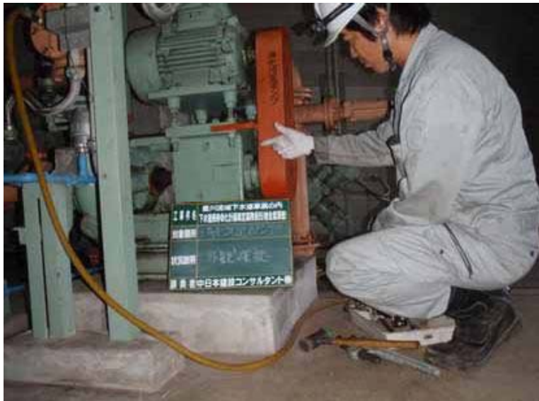
機器名:消化汚泥ポンプ
