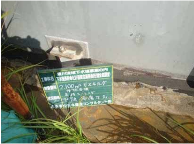
機器名:ガス貯留タンク
