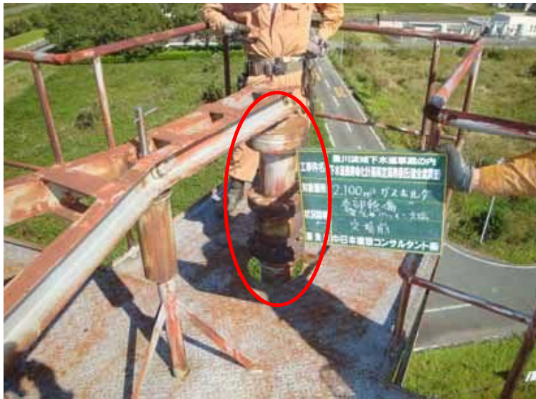
機器名:ガス貯留タンク
