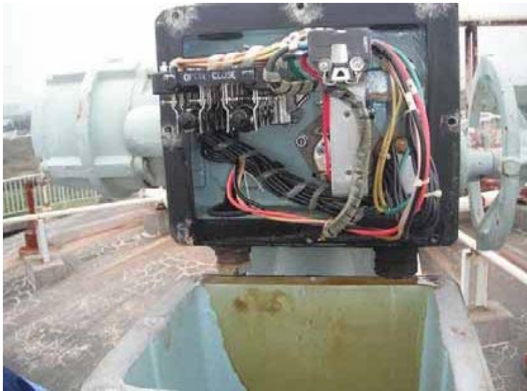
機器名:消化槽汚泥投入弁
