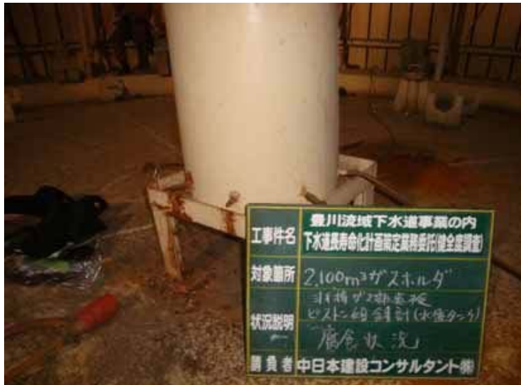
機器名:ガス貯留タンク
