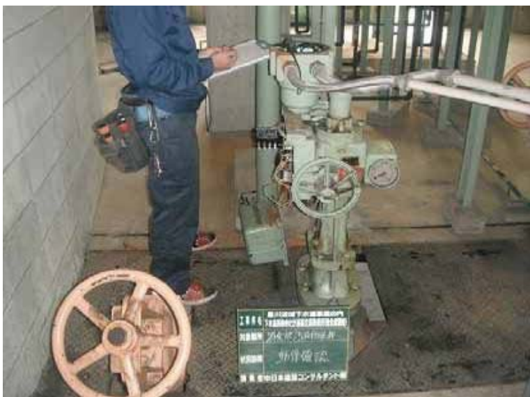
機器名:消化槽汚泥移送弁
