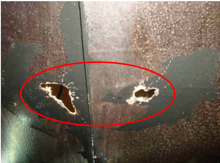
機器名:ガス貯留タンク
