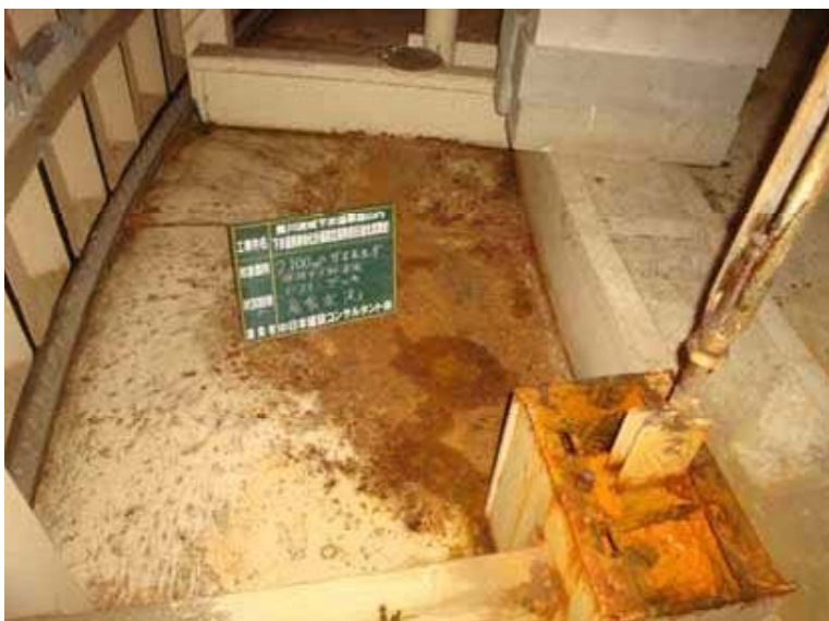
機器名:ガス貯留タンク
