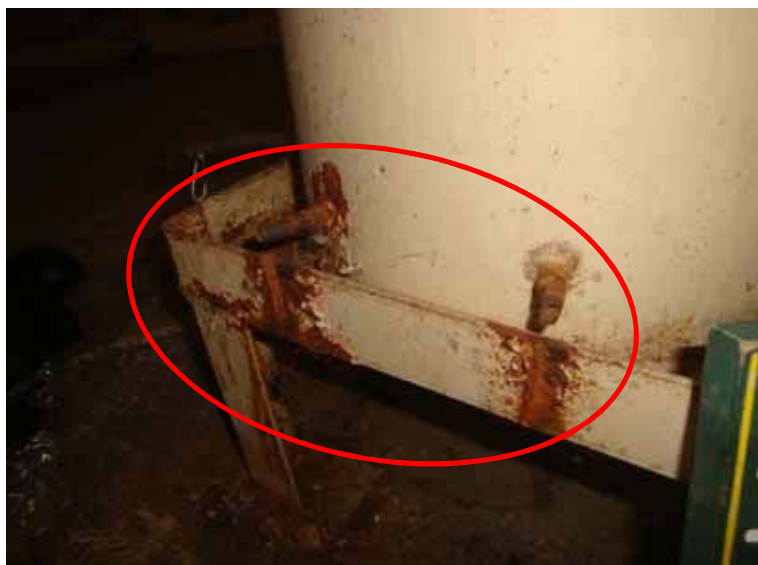
機器名:ガス貯留タンク
