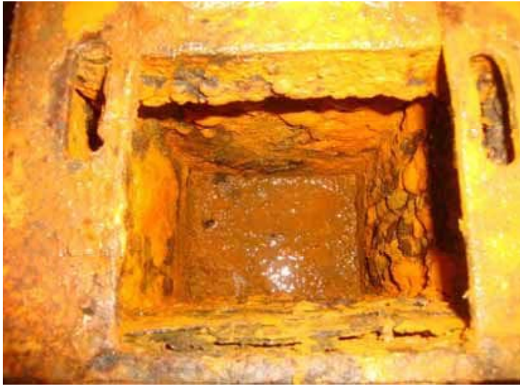
機器名:ガス貯留タンク
