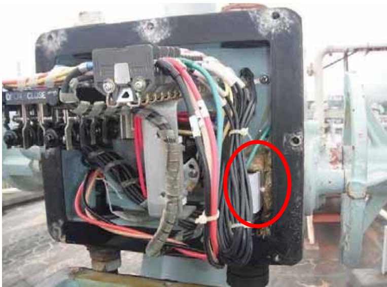
機器名:消化槽汚泥投入弁
