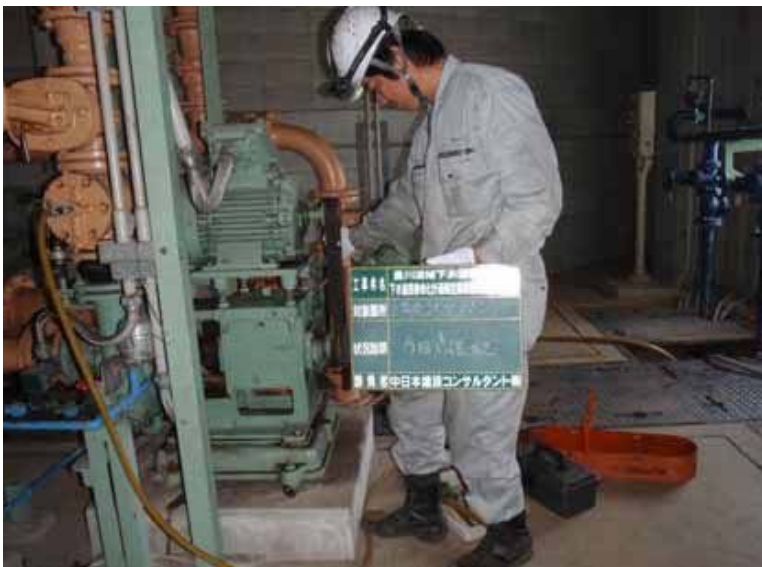
機器名:消化汚泥ポンプ
