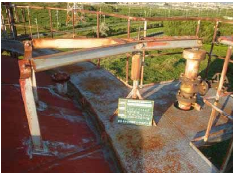
機器名:ガス貯留タンク
