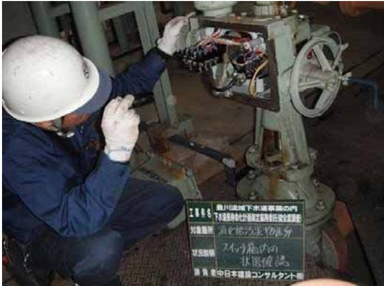
機器名:消化槽汚泥移送弁
