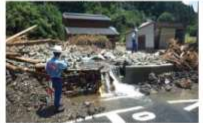
朝倉市中村川被災状況調査
