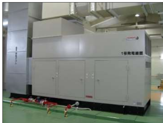
【非常用自家発電設備】
