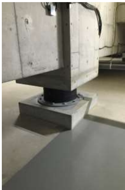
【工場棟に設置された免震システム】
