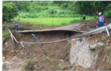
朝倉市黒川地区被災状況調査
