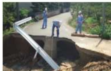
朝倉市宮野の被災状況調査
