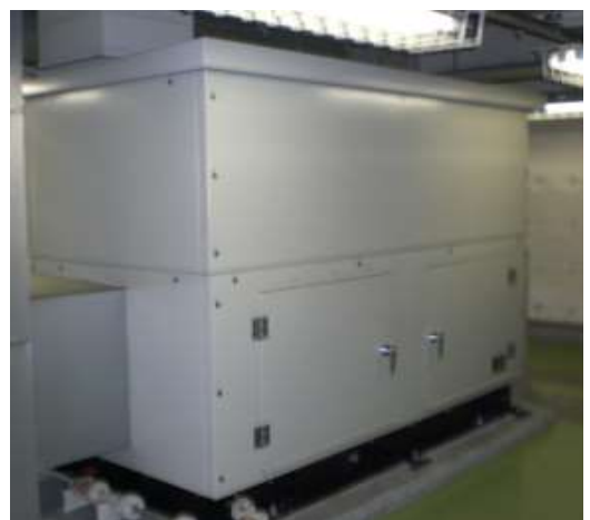
【非常用発電機の72時間化】
