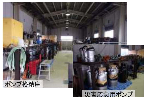
【災害応急用ポンプの準備状況】
