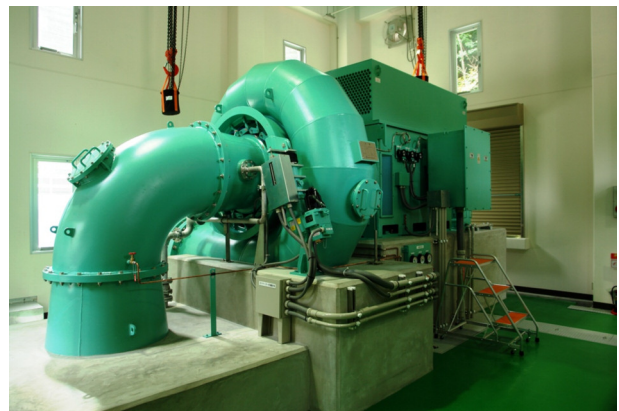
発電機及び水車
