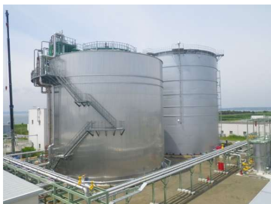
下水汚泥メタン発酵施設
