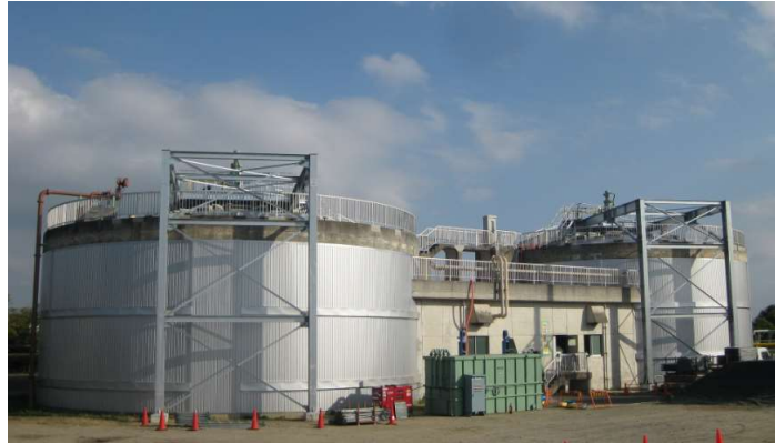
下水汚泥メタン発酵施設
