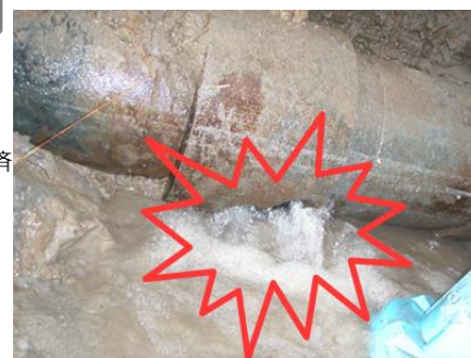
石綿セメント管 破損状況
