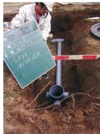
農業集落排水工事(新城市巴地区) (平成22年度管路その5工事)
