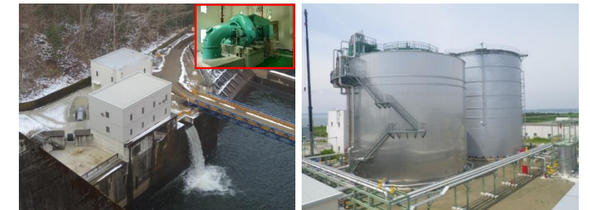
平成 28 年 12 月に本格運転を開始した羽布ダム地区（豊田市）の小水力発電施設（写真奥の建物）
