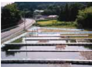
竹ソダ濁水処理システム
