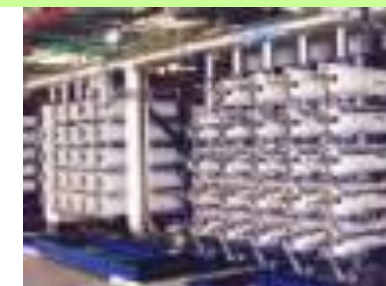
排水再利用 逆浸透膜
