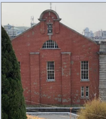
鍋屋上野浄水場 第1ポンプ所被弾痕
